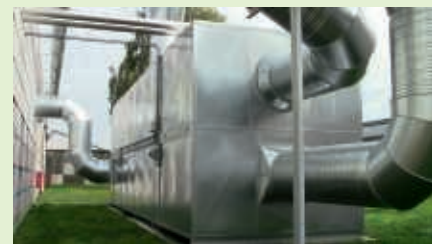
Die neue Anlage für Carl Hansen & Sohn ist mit voller Wärmerückgewinnung geliefert, welches das grüne Profil des Unternehmens erfüllt.
