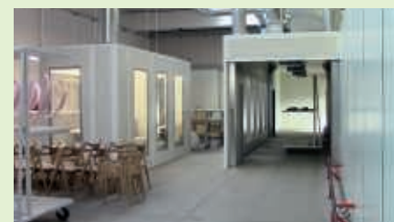
Die neue Lackieranlage enthält u.a. Schleifkabine und Tunneltrockenofen. Aagaard A/S hat außerdem Spezial-Hordenwagen für Möbeltransport in den Trockenofen entwickelt.
